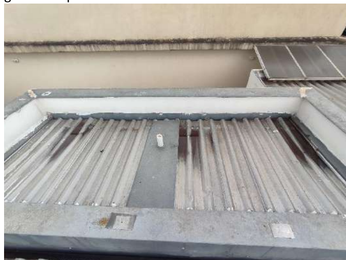
Foto 43. Cobertura sobre os banheiros coletivos. Notar a flexão da telha e o empoçamento de água.
