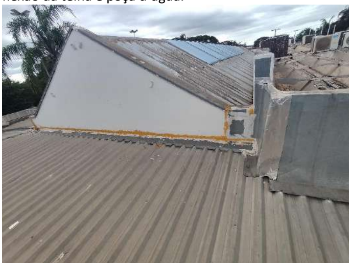
Foto 46. Aspecto do encontro da cobertura dos gabinetes e da galeria. Notar os remendos e a aplicação de espuma para estancar a infiltração no rufo.
