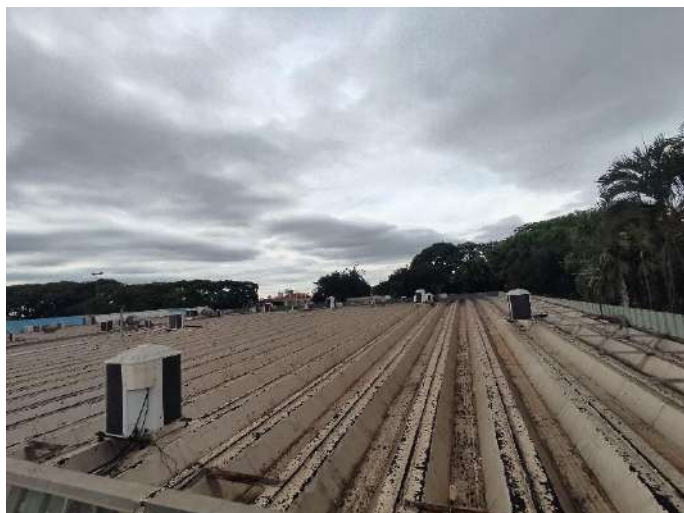
Foto 42. Aspecto da cobertura autoportante. Os pontos escuros são falhas na manta asfáltica.
