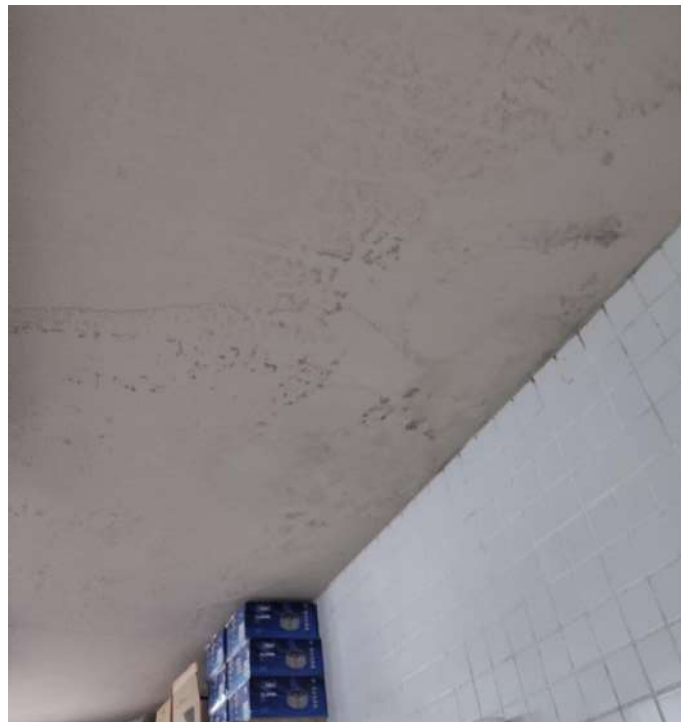
Foto 33. Umidade na laje de forro do núcleo de manutenção proveniente de infiltração da cobertura.
