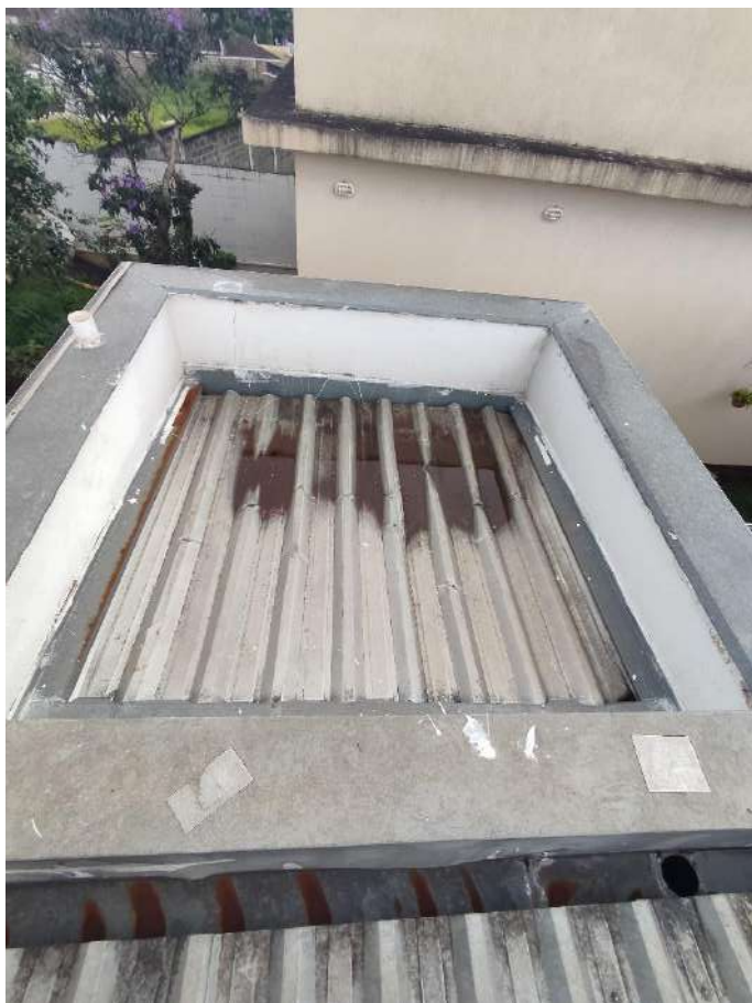
Foto 44. Aspecto da cobertura sobre o banheiro acessível da sala de reuniões Ver. Mauro Vieira. Notar os remendos, flexão da telha e poça d'água.
