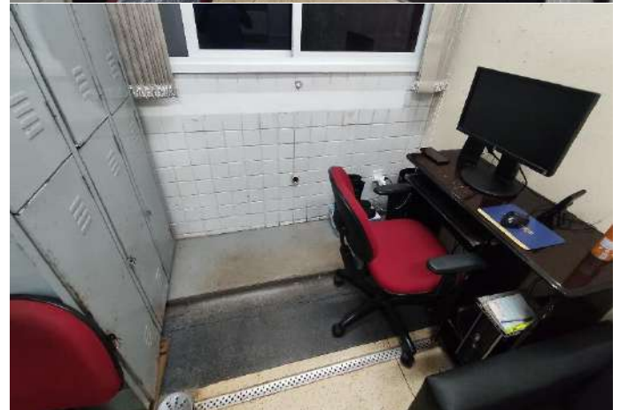
Foto 14 (a e b). Sala de descanso funcionárias da manutenção improvisada na antiga copa. Tubulação de esgoto aberta. Iluminação e ventilação prejudicada pela área de serviço (foto 2).
