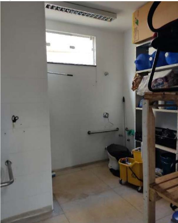
Foto 5. Sanitário acessível do Bloco do Núcleo de Manutenção sendo utilizado como depósito de materiais de limpeza.
