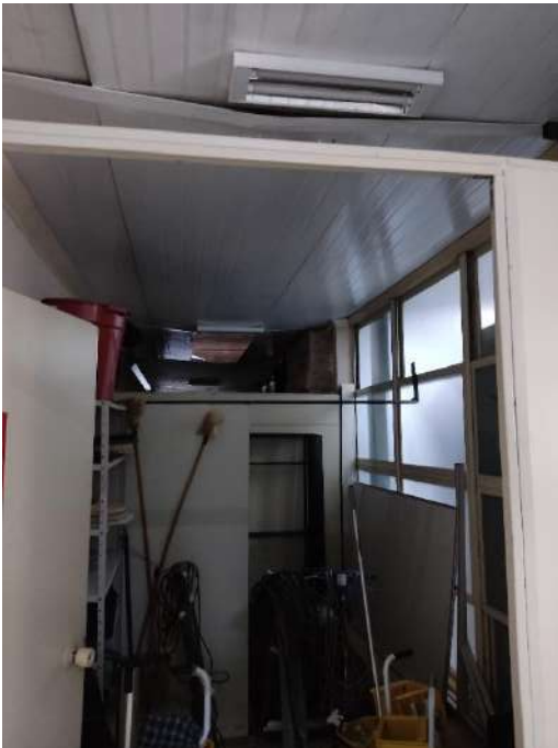
Foto 3. Almojarifado e depósito da manutenção situado de forma improvisada no corredor central atrás da sala do departamento de informática.
