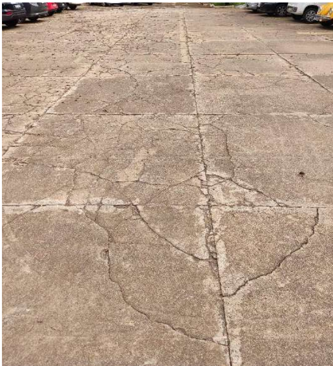
Foto 32. Aspecto do pavimento de concreto do estacionamento à esquerda da testada do imóvel.
