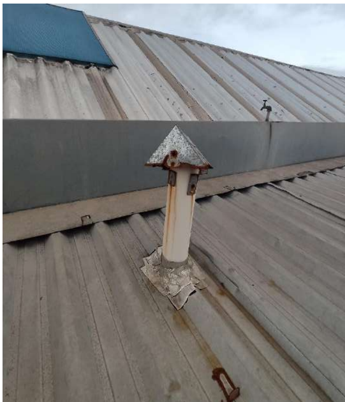
Foto 50. Ventilação do sanitário acessível da recepção.
