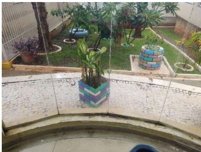
Foto 40. Infiltração na base do caixilho da sala de reuniões Ver. Mauro Vieira.
