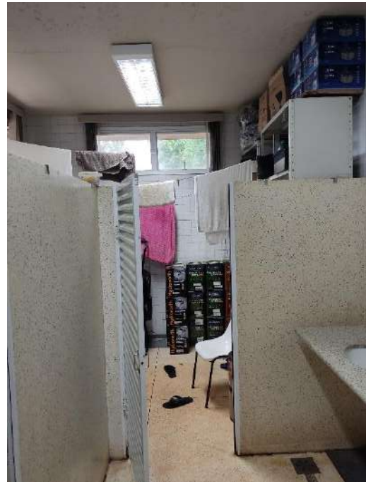
Foto 4. Sanitário e vestiário masculino do Bloco do Núcleo de Manutenção. Observar que parte do vestiário é utilizado como depósito de materiais. Varal improvisado
