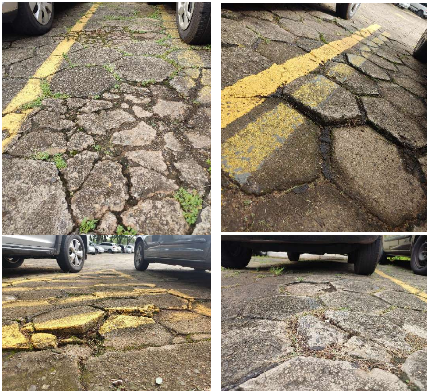
Foto 64 a 69. Condições da pavimentação de bloquete sextavado do estacionamento que comprometem a acessibilidade.
