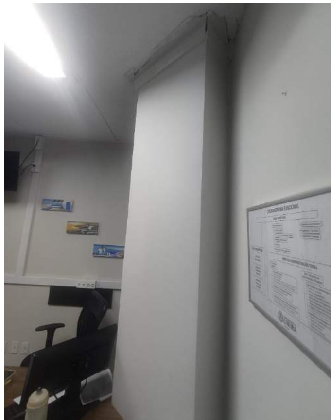
Foto 31. Elemento estrutural no meio do ambiente da Sala do Secretário Legislativo. Existem mais 4 ocorrências desse tipo em espaços de circulação e sala de reunião.
