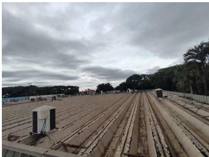
Foto 42. Aspecto da cobertura autoportante. Os pontos escuros são falhas na manta asfáltica.
