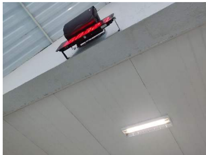
Foto 41. Infiltração (gotejamento) no hall/galeria dos gabinetes parlamentares.
