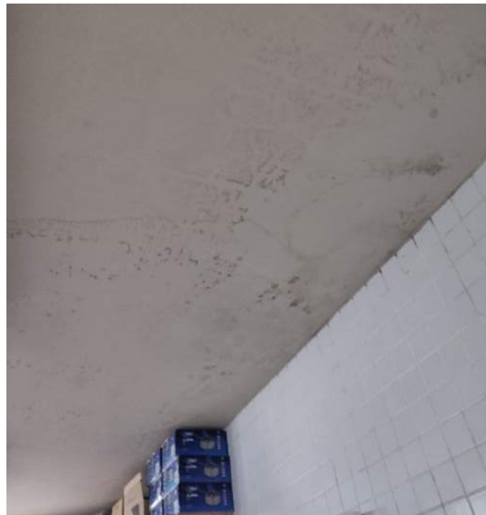
Foto 33. Umidade na laje de forro do núcleo de manutenção proveniente de infiltração da cobertura.
