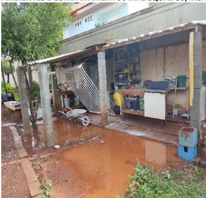
Foto 1. Oficina improvisada instalada na divisa lateral esquerda. Ausência de fechamento adequado, problemas de drenagem e pavimentação.
