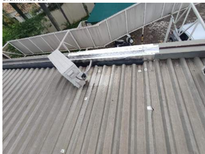
Foto 47. Cobertura sobre os gabinetes parlamentares. Notar os pontos de remendos improvisados com manta aluminizada em razão do equipamento de ar condicionado.
