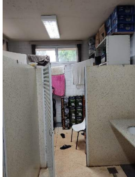
Foto 4. Sanitário e vestiário masculino do Bloco do Núcleo de Manutenção. Observar que parte do vestiário é utilizado como depósito de materiais. Varal improvisado
