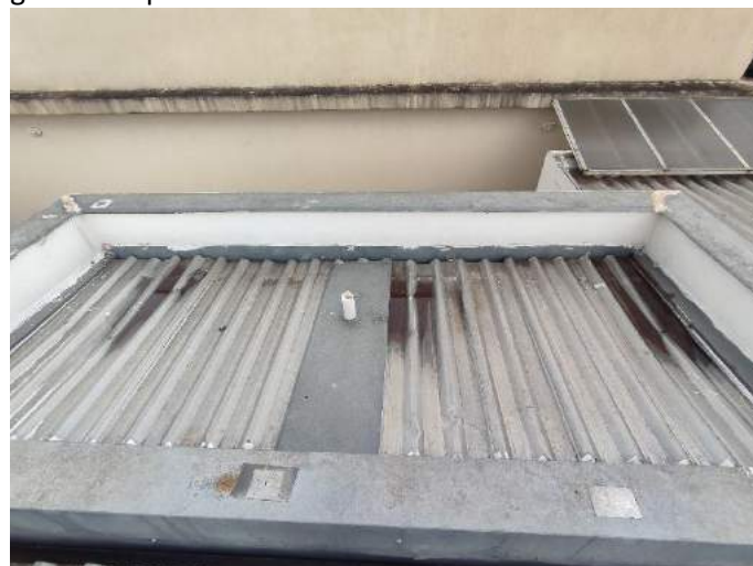
Foto 43. Cobertura sobre os banheiros coletivos. Notar a flexão da telha e o empocamento de água.
