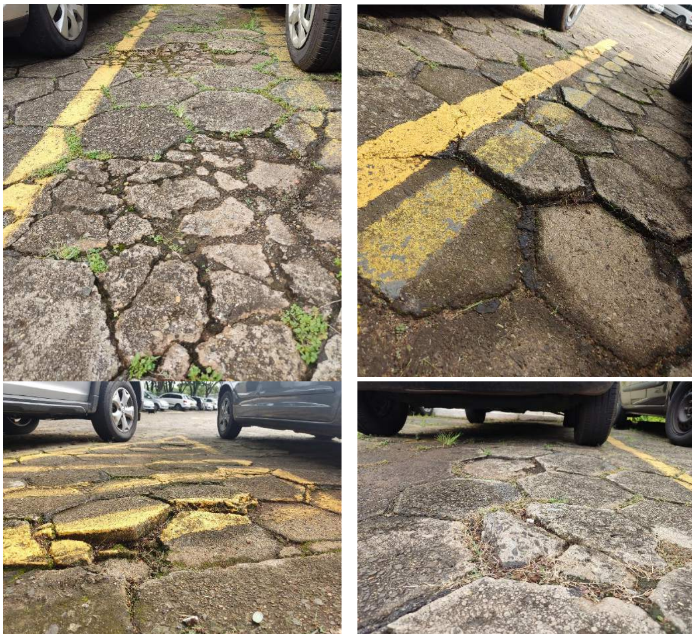
Foto 64 a 69. Condições da pavimentação de bloquete sextavado do estacionamento que comprometem a acessibilidade.
