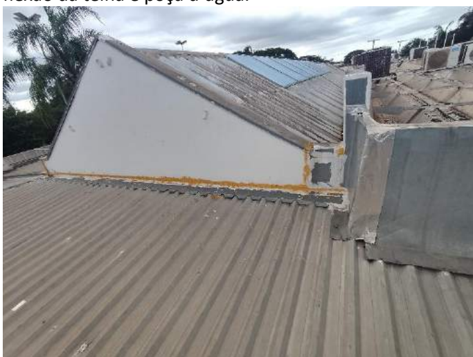
Foto 46. Aspecto do encontro da cobertura dos gabinetes e da galeria. Notar os remendos e a aplicação de espuma para estancar a infiltração no rufo.
