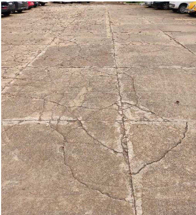
Foto 32. Aspecto do pavimento de concreto do estacionamento à esquerda da testada do imóvel.
