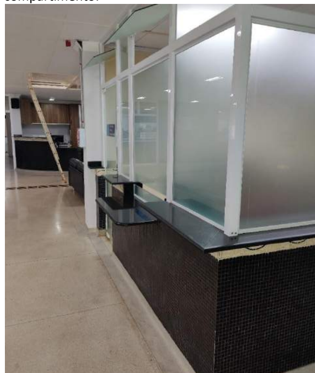
Foto 10. Sala da Consultoria Técnica Especializada. Fechamento improvisado executado sobre um balcão de um espaço que antes era uma recepção do plenário. A sala é localizada no hall, em área de grande circulação, sem aberturas para o exterior.
